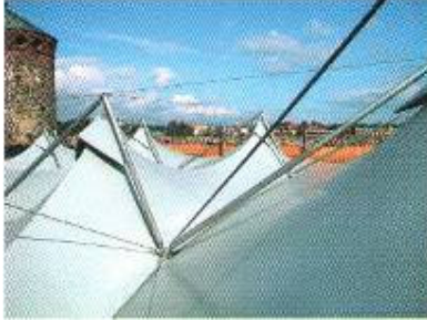
Kuumasinkittyjä kattorakenteita kulttuuri rakennuksessa.
